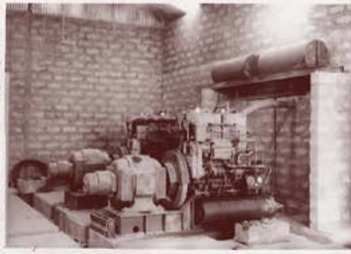
Centrale Electrique provisoire Deux premiers groupes Alsthom 69 K.V.A.
