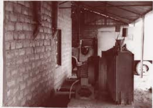
Aéroréfrigérateurs de la Centrale électrique provisoire .
